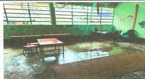
Foto 3: Sustitución de lámina (filtración de agua)
